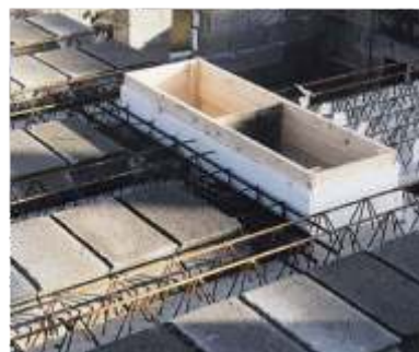
Obr. 12 - D ev né bedn ní prostupu
