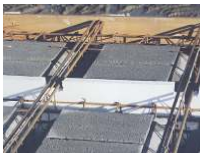
Obr. 11 - P erušení tepelného mostu
