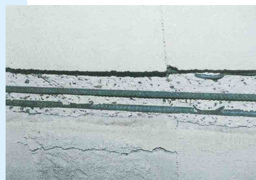
Detail trámce a vložek po zkoušce
